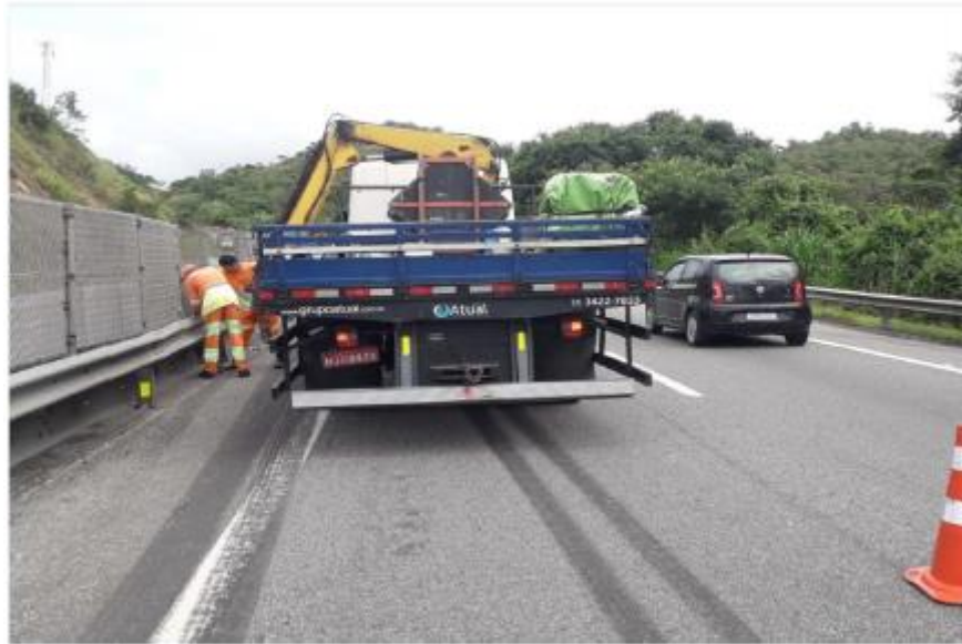
Figura 6.6 Via Lagos – Dispositivo de segurança
